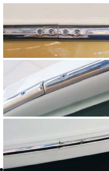
Examples of applications without joint cap: anti-aesthetic holes, cuts and unaligned bars Esempi di applicazioni senza coprigiunta: fori antiestetici, tagli e barre non allineate
